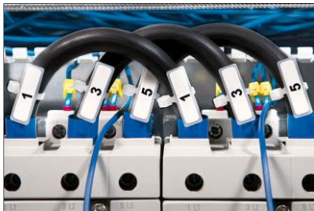
IT Kabelbinder – ein Arbeitsgang mit doppeltem Nutzen.
