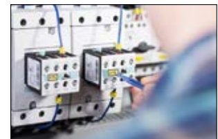
Sicherheit und Übersichtlichkeit im Schaltschrank mit HELASIGN-Etiketten.
