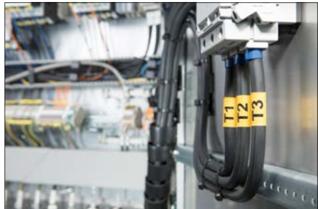
TLFD DS Schrumpfschlauchmarkierer für mehr Sicherheit und Übersichtlichkeit im Schaltschrank.
