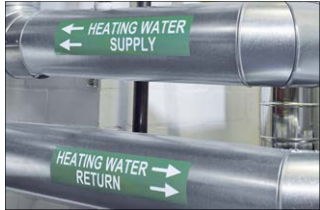
Große und gut sichtbare Rohrleitungsmarkierung.
