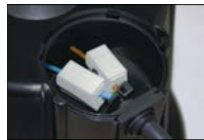
HelaCon Lux verbunden mit der Stromversorgung.
