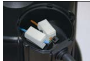
HelaCon Lux verbunden mit der Stromversorgung.
